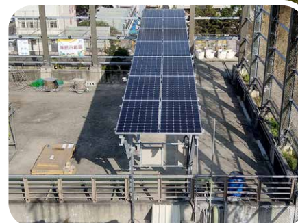
太陽能板及風力發電裝置
